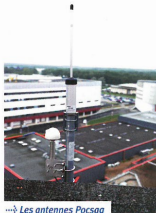
Les antennes Pocsag
